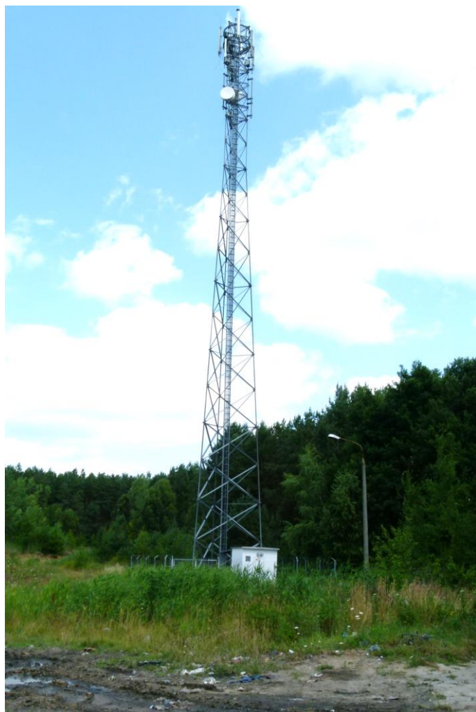
Ryc. nr 7. Maszt telefonii komórkowej przy wschodniej granicy terenu składowiska, obiekt wydzielony i wygradzony z terenu składowiska.
