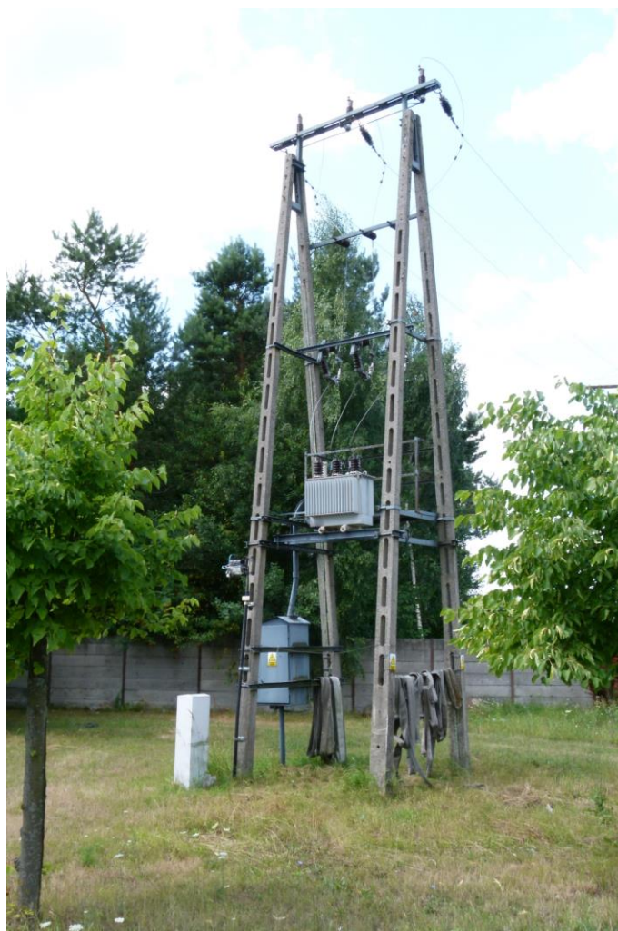
Ryc. nr 6. Stacja TRAFO na terenie składowiska odpadów zasilająca w energię obiekty składowiska.
