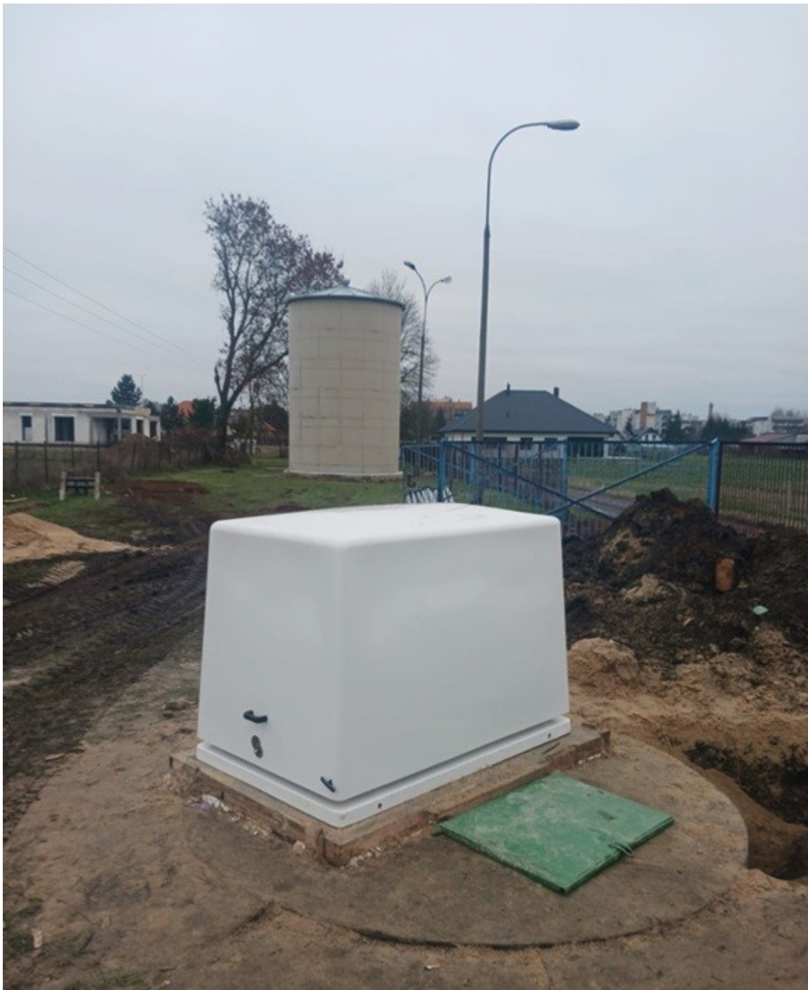
Foto 2. Modernizacja studni głębinowych na ujęciu wody w Beżycach. Źródło: Urząd Miejski w Beżycach.
